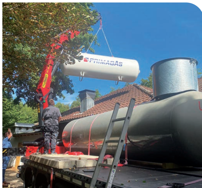
Der Gastank wird über das Gebäude gehoben, um seinen Standort zu erreichen. (Foto: Bernd Armbruster)
